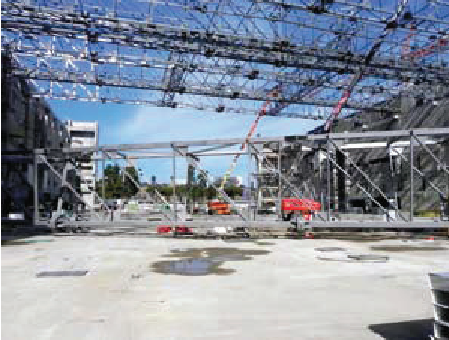
מראה כללי של אולם האירועים בבנייתו המקנה מושג לגבי גודלו. האולם ישתרע בין שני המבנים שבצילום בחלל של 7,150 מ"ר. תקרת האולם תישען על 11 אגדי פלדה שחלקם כבר נראים בתמונה, ועל שני גמלונים בפתחים
